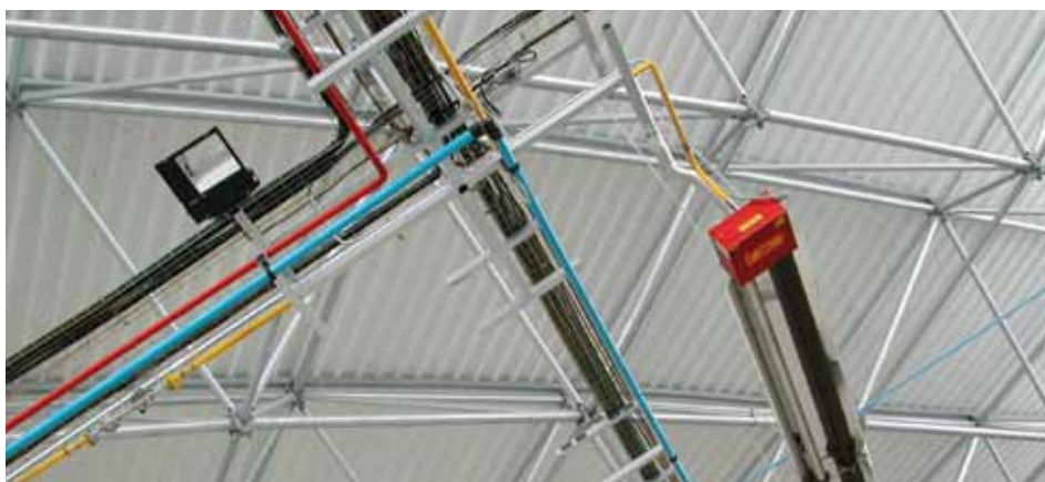
Calefacción Radiante, la mejor solución para naves industriales.
